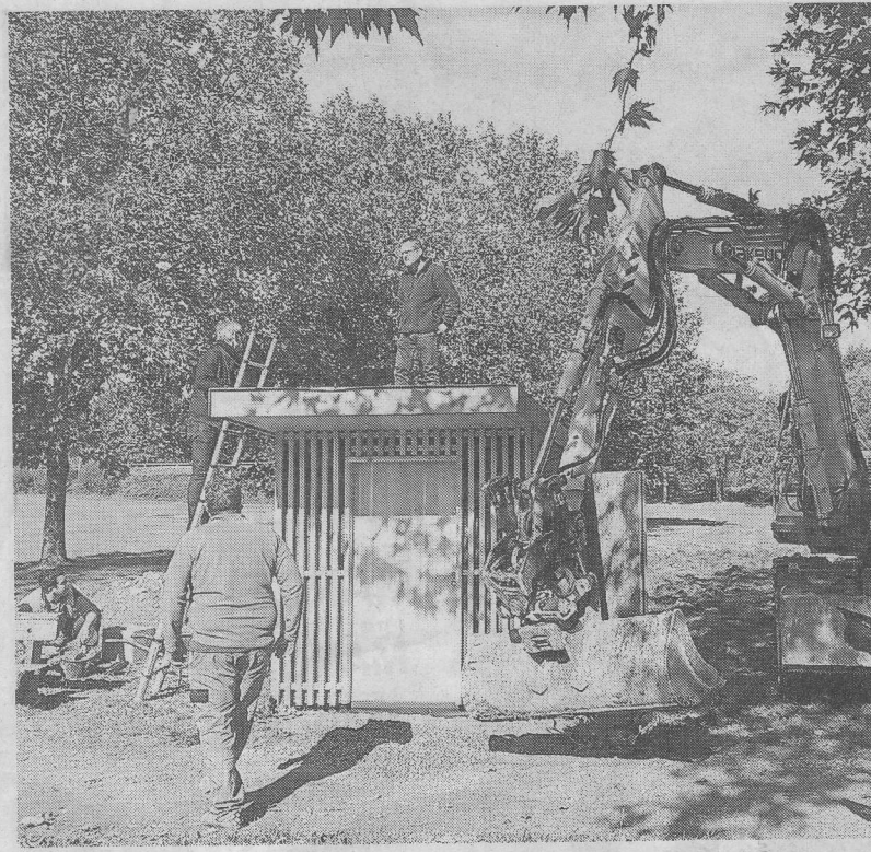
Des toilettes sèches autonomes à lombricompostage ont été installées, mercredi sur la base de loisirs de l'étang.
